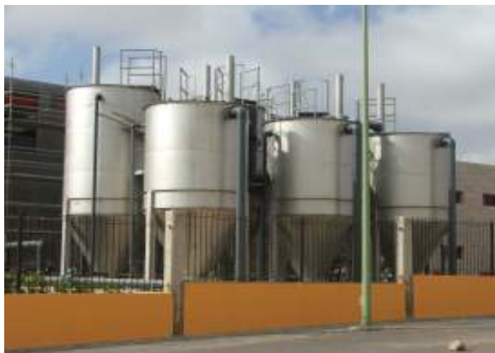
Filtros del terciario de Puerto del Rosario
